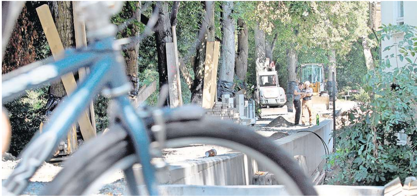
Im Jahr 2014 war der Trojedamm eine Baustelle, im kommenden Jahr soll er für 500 000 Euro instandgesetzt werden. FOTO: THORSTEN RICHTER
