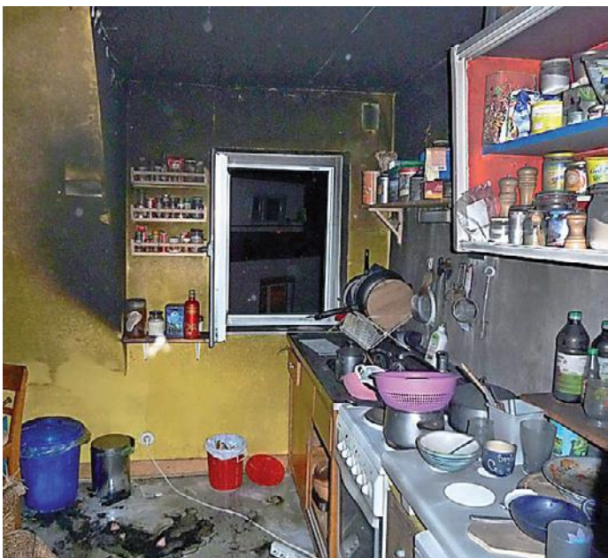
Der Brand in einer Küche in Ockershausen endete glimpflich. Die Feuerwehr war schnell vor Ort. Foto: Feuerwehr
