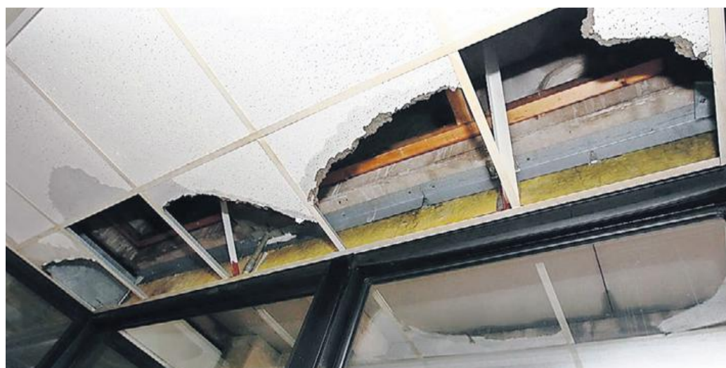
Verheerende Wirkung: Eine vom Wasser zerstörte Zwischendecke im Bereich des Arbeitskreises Radiochemie im Mehrzweckgebäude. Fotos: Michael Hoffsteter
