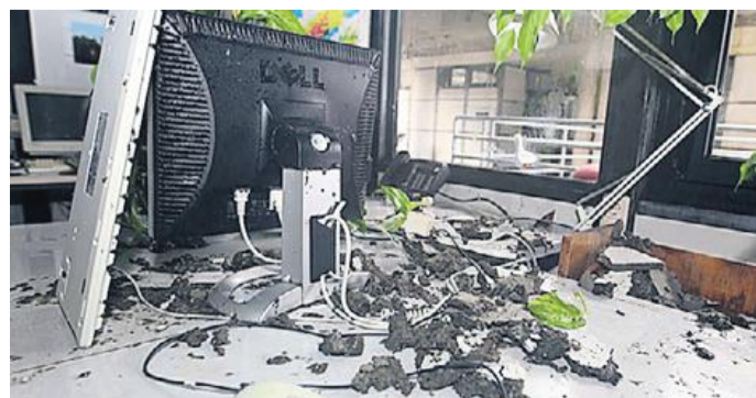
Vollgesogene Dämmstoffbrocken und durchnässte Computer in den Büros der Radiochemie. Foto: Michael Hoffsteter
