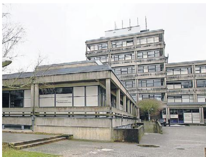
In der Hans-Meerwein-Straße ist der Fachbereich Chemie untergebracht. Im Gebäudeteil J trat das Wasser aus.
