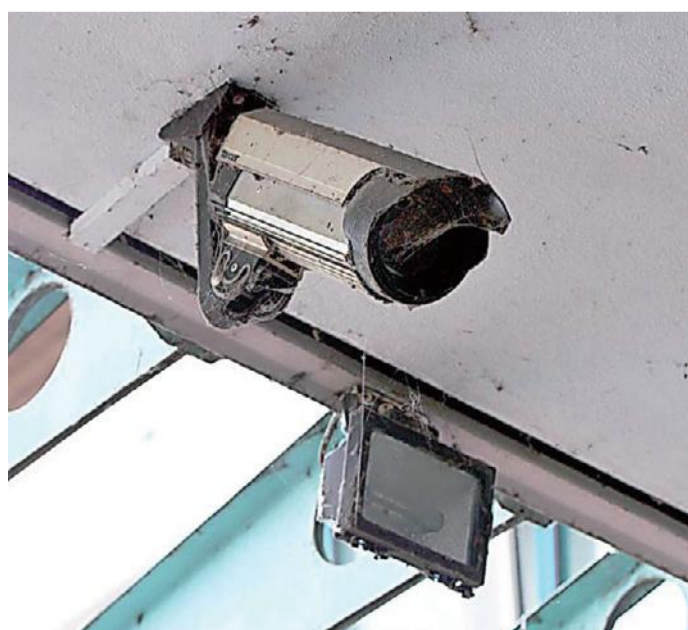
Bereits jetzt ist eine Videokamera zur Überwachung des unteren Eingangs am Oberstadtaufzug installiert. Foto: Thorsten Richter
