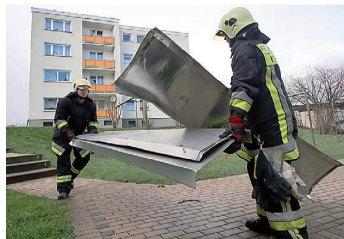
In der Fontanestraße in Wetter hatte der Sturm die Seitenverkleidung am Dach eines Mehrfamilienhauses abgerissen.
