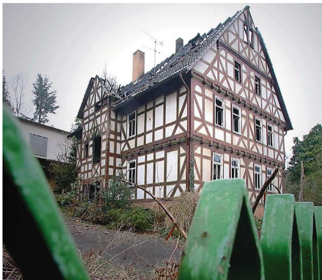
Die Zukunft des Fachwerk-Denkmal in der Brunnenstraße hängt laut dem Haus- und Grundstückseigentümer direkt mit der Entwicklung des Baugebiets „Auf der Eich“ zusammen. Archivfoto
