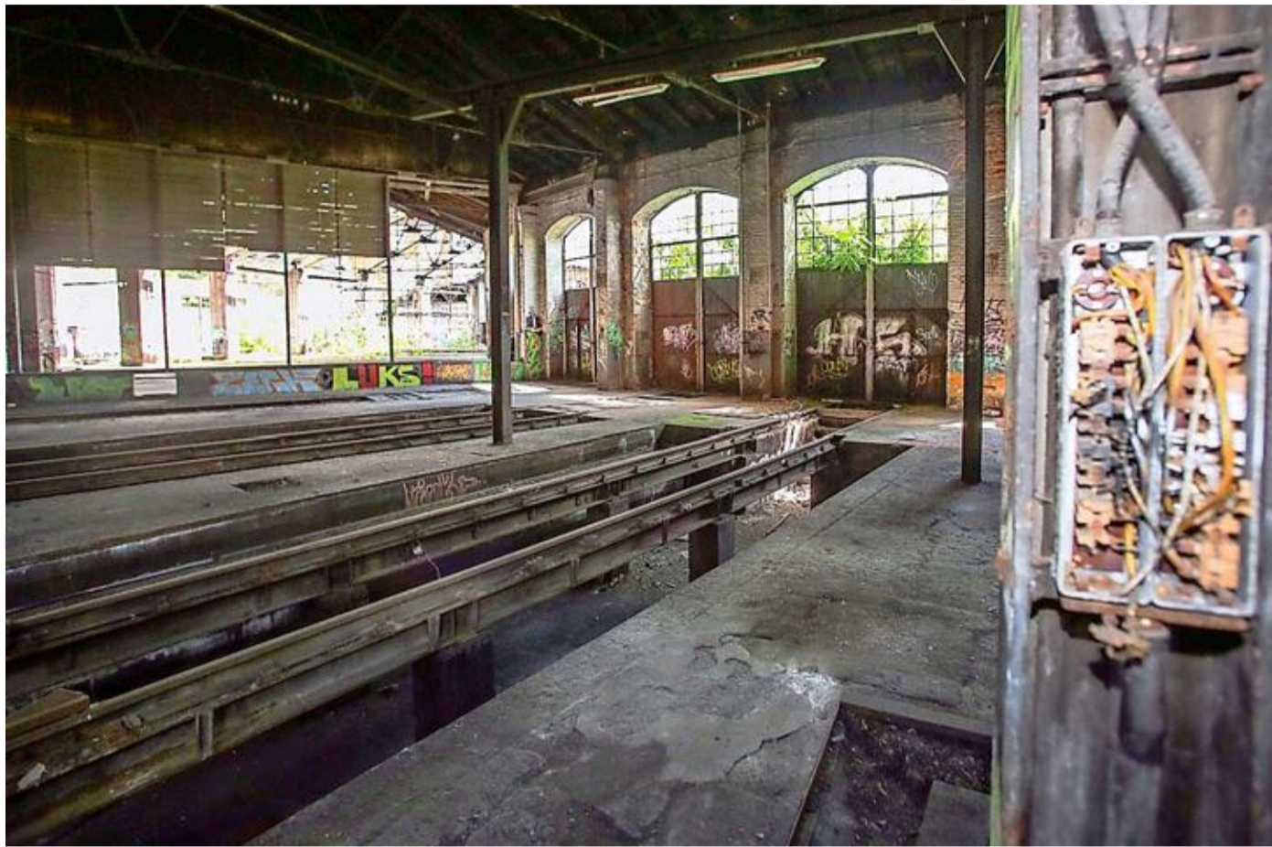
Bis vor fünf Jahren war der Lokschuppen Eigentum der Deutschen Bahn. Seitdem hat die Stadt nach eigenen Angaben mehr als 200 000 Euro in die Instandhaltung des „akut einsturzgefährdeten“ Gebäudes investiert.
