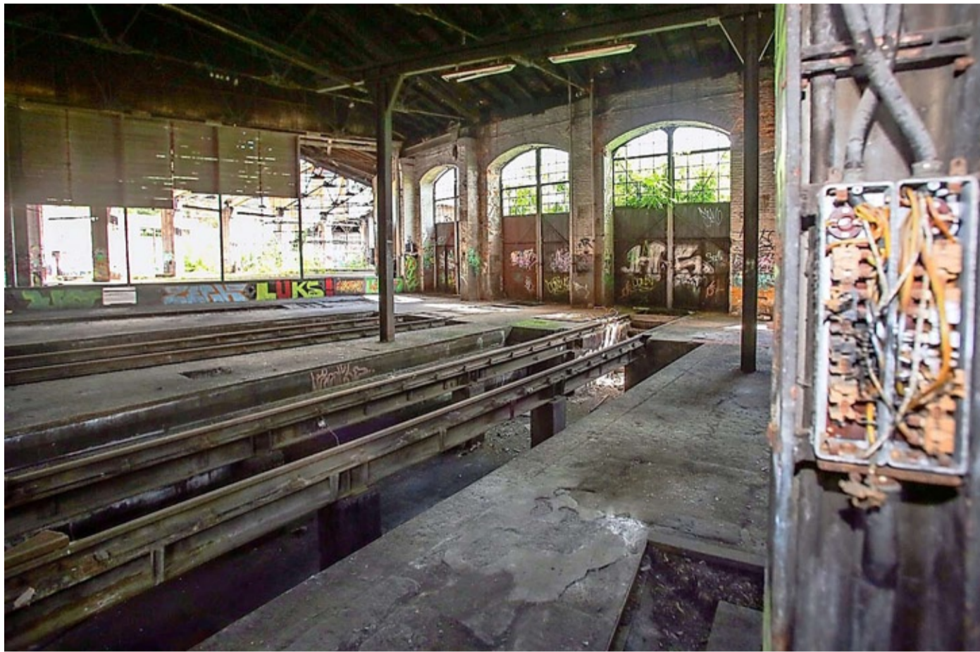
Bis vor fünf Jahren war der Lokschuppen Eigentum der Deutschen Bahn. Seitdem hat die Stadt nach eigenen Angaben mehr als 200 000 Euro in die Instandhaltung des „akut einsturzgefährdeten“ Gebäudes investiert.
