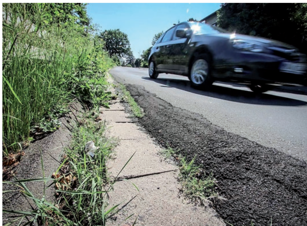
Wegen der Fahrbahnschäden im Höhenweg fordert der Ortsbeirat den Magistrat dazu auf, die Straße für Lastwagen zu sperren.
