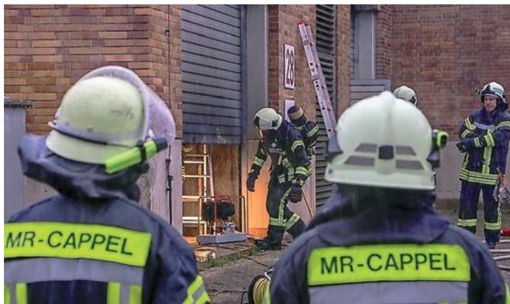
Gegen 17 Uhr am Freitagnachmittag bekämpften die Einsatzkräfte den Brand an einem Schaltschrank der Kläranlage.
